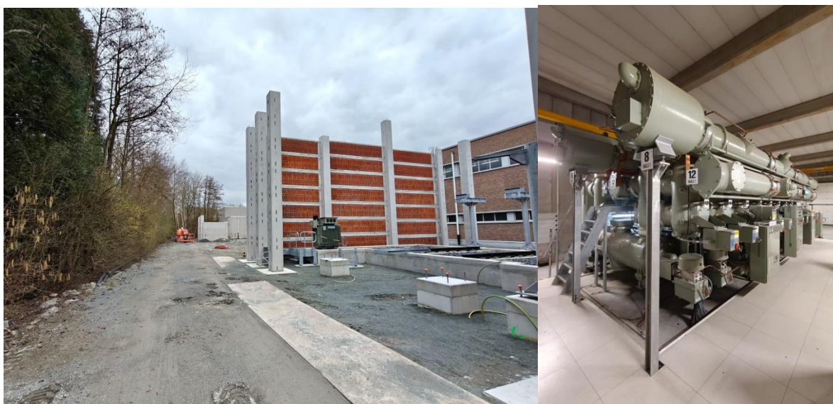
Figuur 1.5 : 150 kV onderstation van het type GIS
