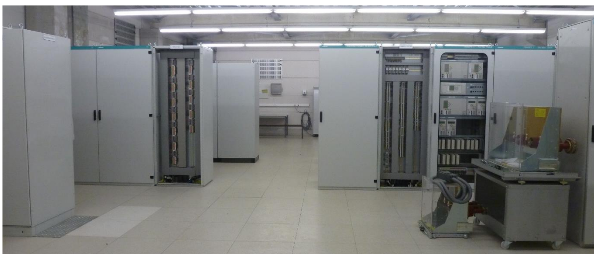
Figuur 1.6 : secundaire uitrustingen van een onderstation
