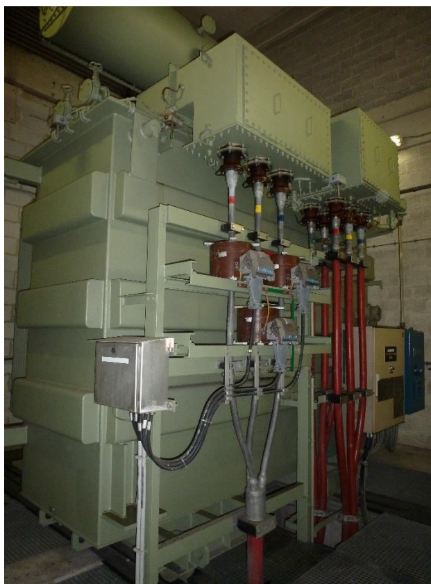
Figuur 1.3 : Ondergrondse kabels aangesloten op een transformator
