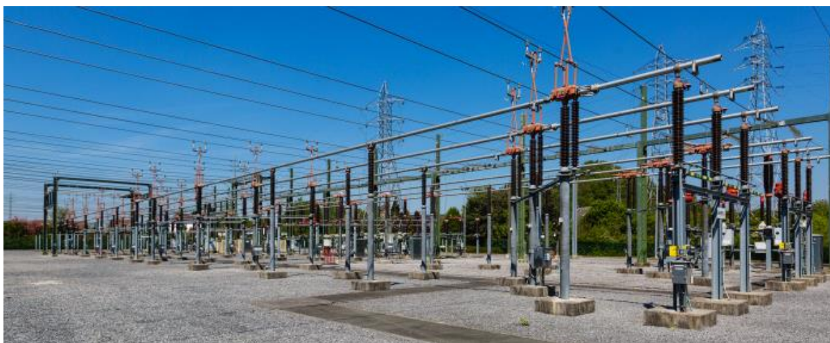
Figuur 1.4 : 150 kV onderstation van het type AIS
