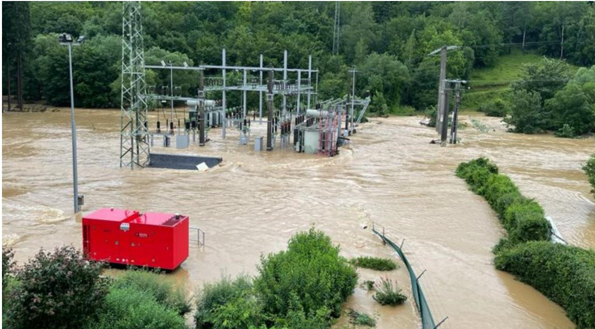
Figuur 2.8 : Overstroming van een hoogspanningspost ten gevolge van de overstromingen na de extreme regenval in juli 2021
