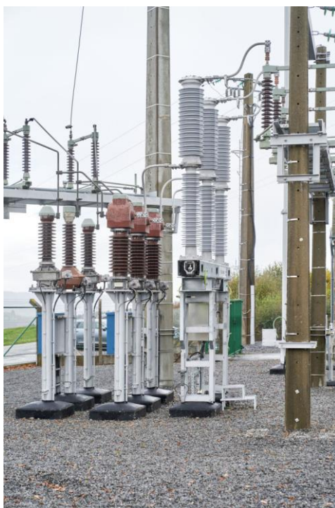
Figuur 2.6 : Eerste SF6-vrije vermogenschakelaar van een nieuwe generatie op Elia-net op 70kV (Onderstation van Marcourt 70kV)
