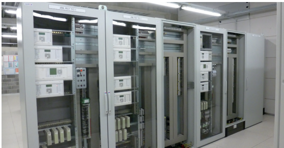
Salle de contrôle d'un poste à haute tension 380 kV
