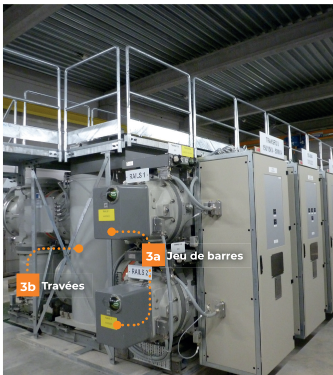
Intérieur d'un bâtiment GIS avec appareillage de commutation
