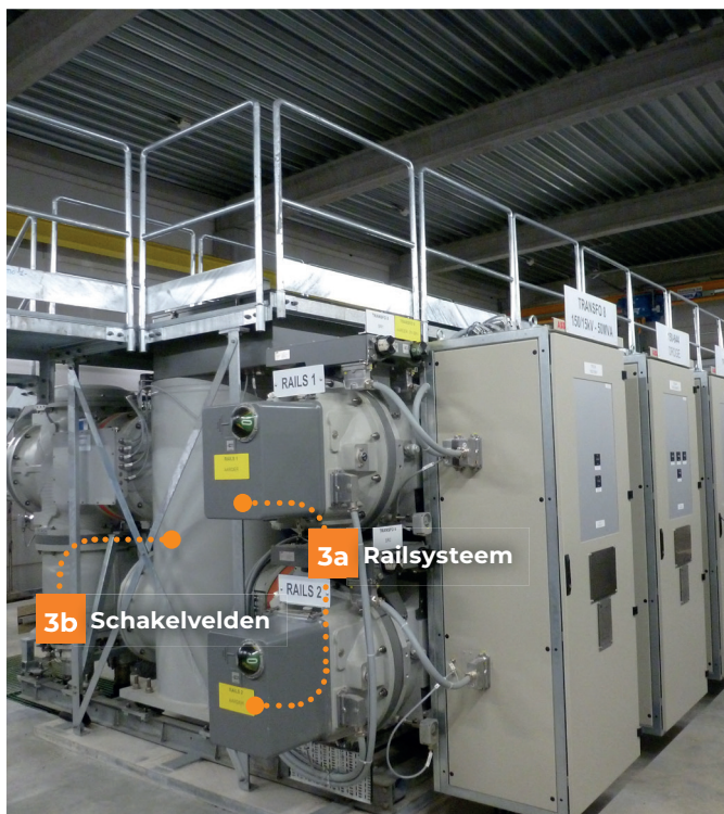
Binnenkant GIS-gebouw met schakelapparatuur
