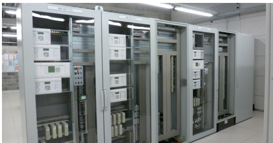
Controlerimte van een 380kV-hoogspanningsstation
