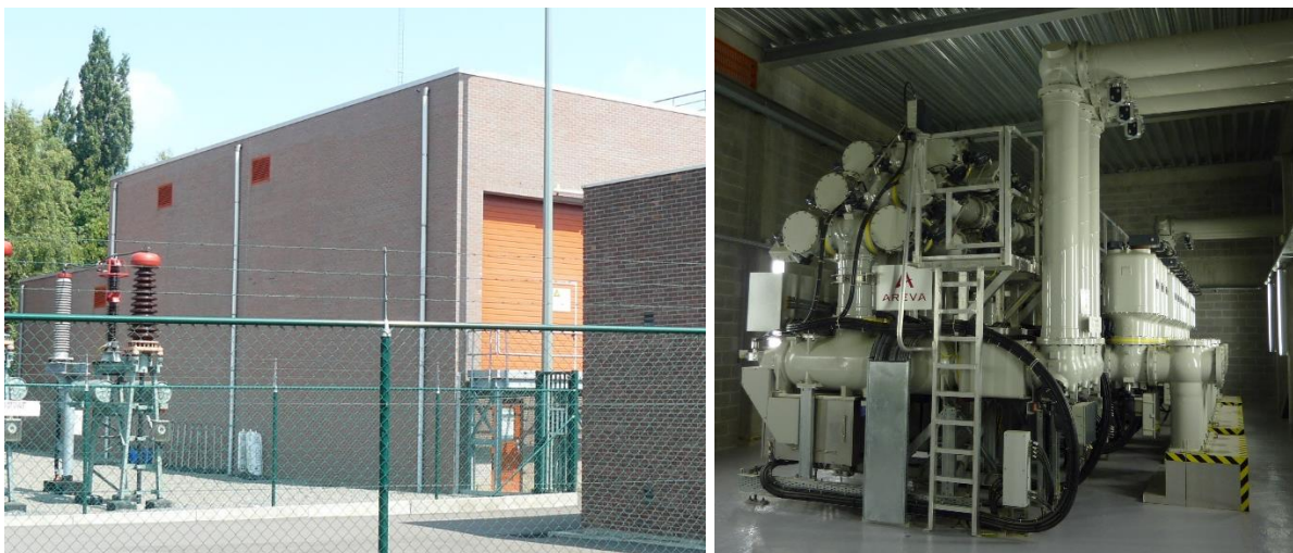
Figuur 1.5: 150 kV onderstation van het type GIS
