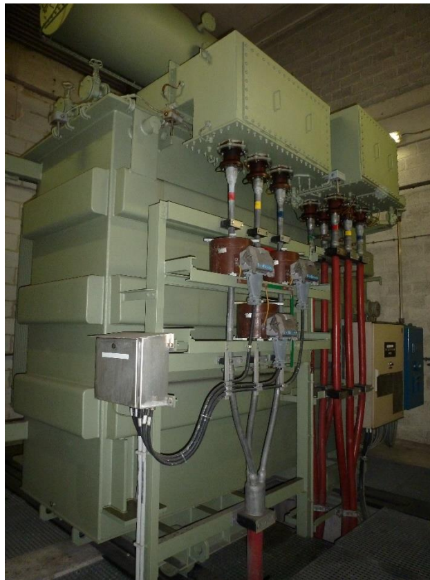
Figuur 1.3: Ondergrondse kabels aangesloten op een transformator
