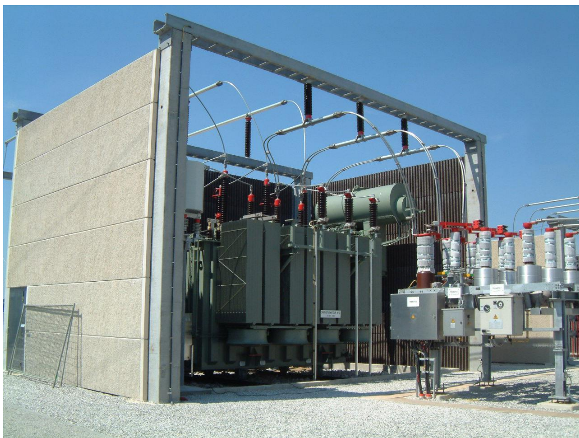
Foto 1: Zicht op een vermogenstransformator 380/150 kV opgesteld boven betonnen opvangkuip, omgeven door geluidsmuren.
