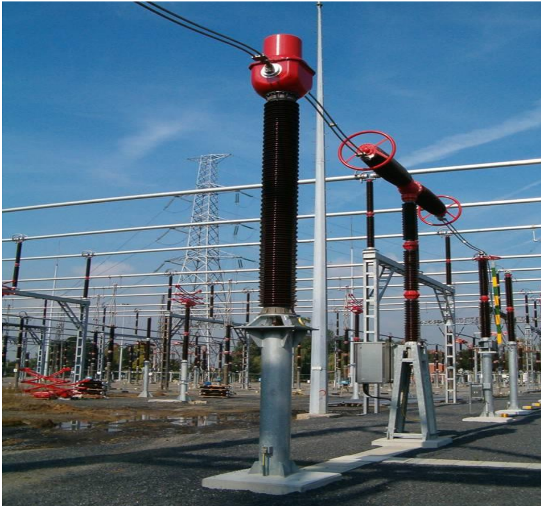
Foto 6: Stroomtransformator met daarachter een vermogensschakelaar
