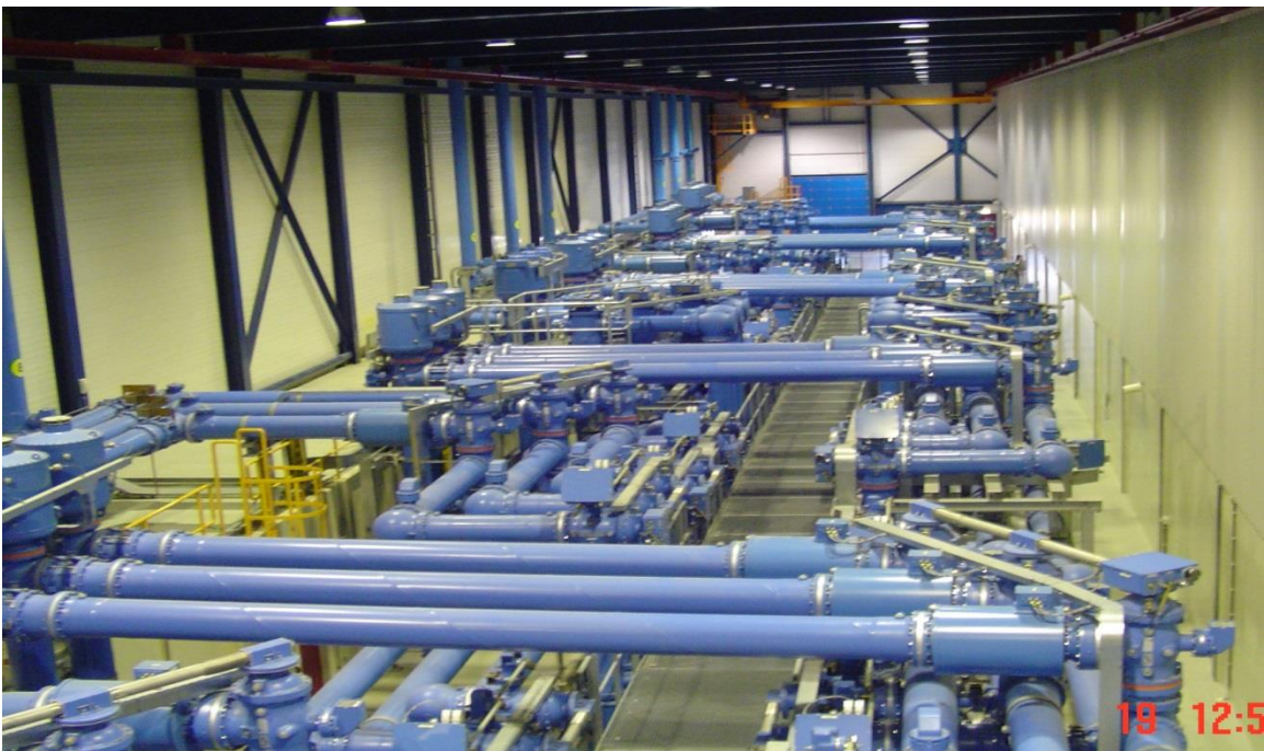
Foto 3: Velden 380kV in een GIS opstelling
