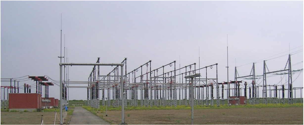
Foto 2: Velden 380 kV in openluchtopstelling (AIS)
