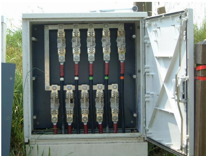
Figure 17 : Exemple d'armoire de jonction
