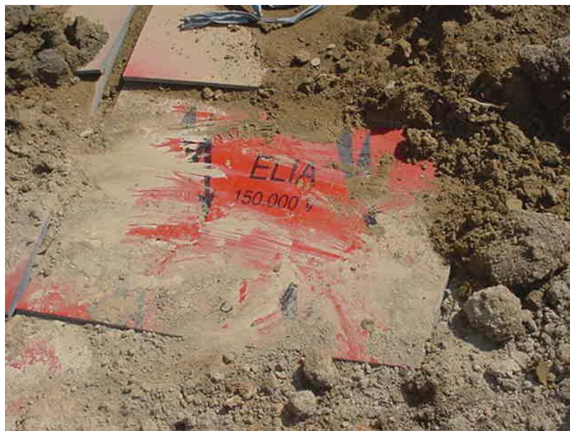
Figure 23 : Protection de câble à haute tension avec des plaques en plastique
