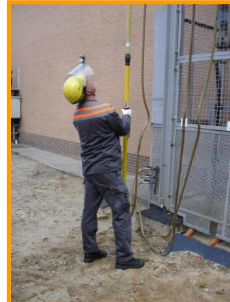
Utilisation du point de terre abaissé
