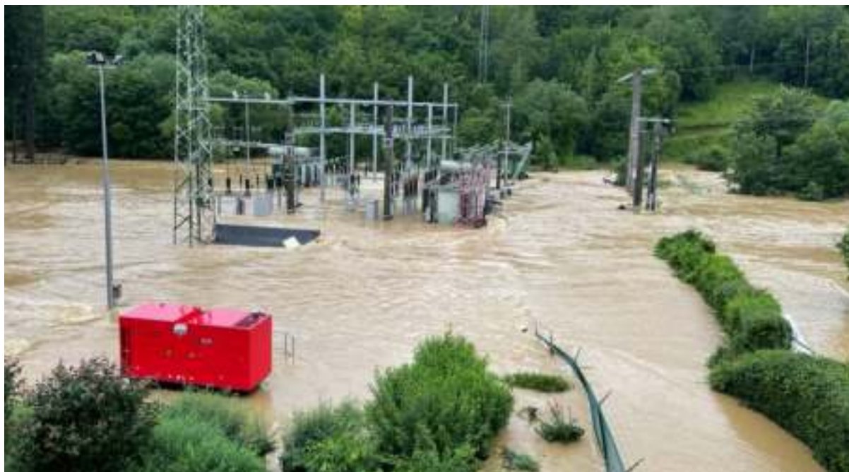
Figure 2.5 : Inondation du poste On suite aux pluies extrêmes de juillet 2021
