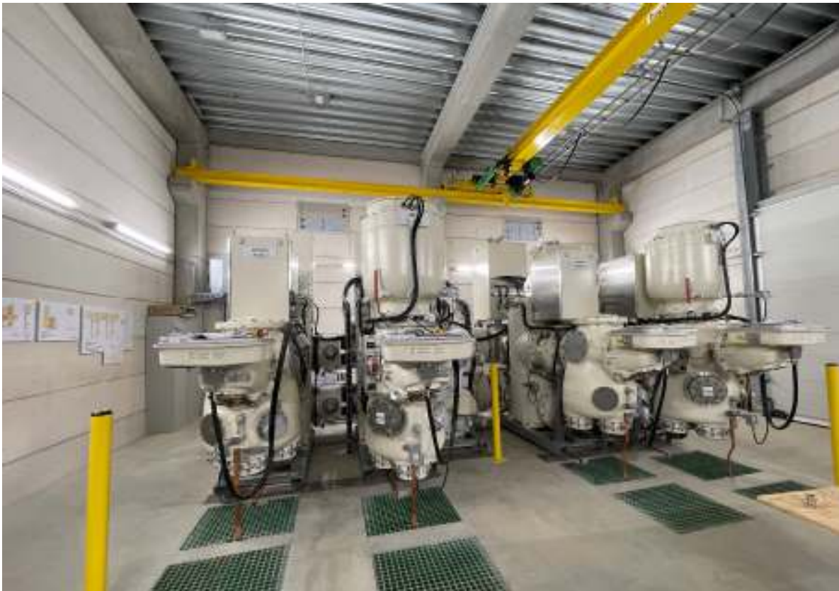
Figure 2.2 Sous-station GIS de Bomal
