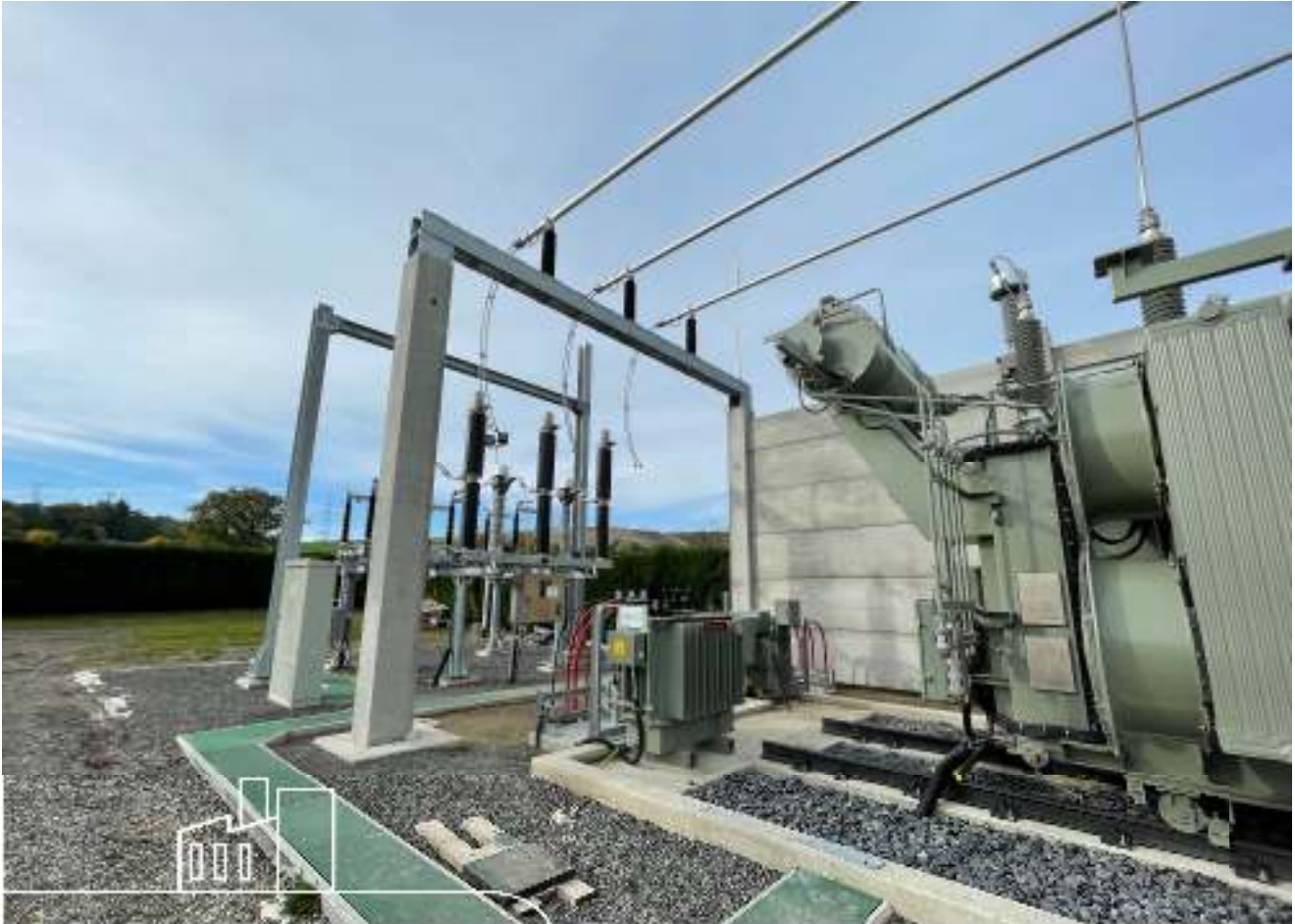
Nouveau transformateur à Trois-Ponts
