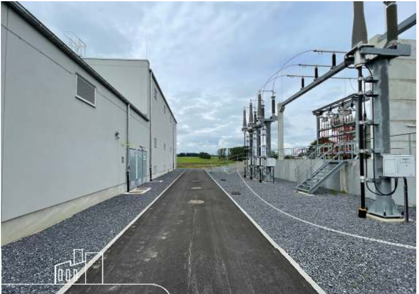
Transformateurs à Neufchâteau
