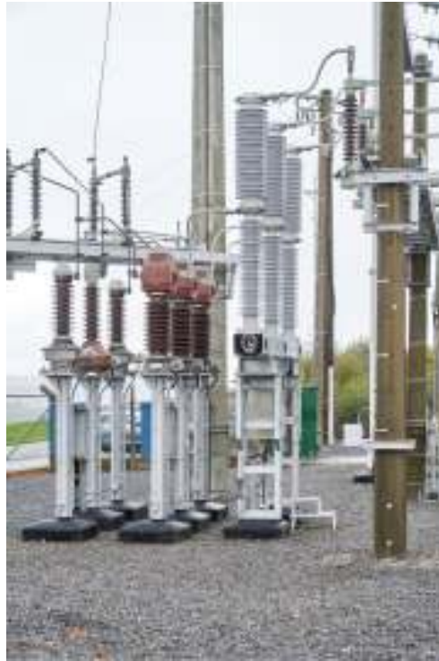
Figure 2.3 Premier disjoncteur sans SF 6 d'une nouvelle génération sur le réseau 70kV d'Elia (sous-station 70kV de Marcourt)
