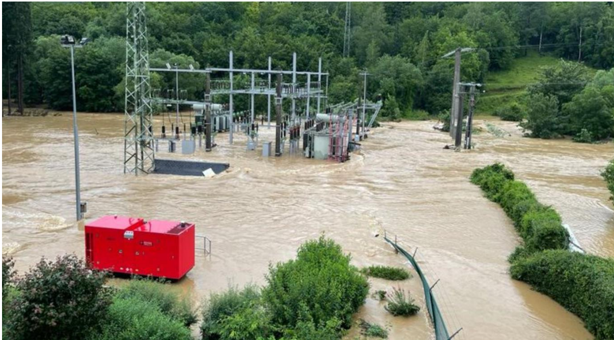
Figure 2.8 : Inondation d'un poste à haute tension suite aux pluies extrêmes de juillet 2021
