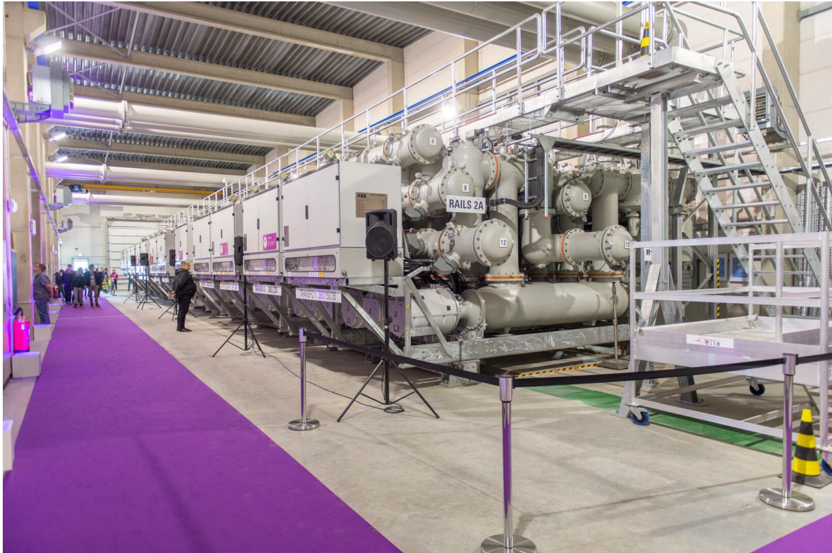
Figure 2.5: Sous-station GIS de Stevin
