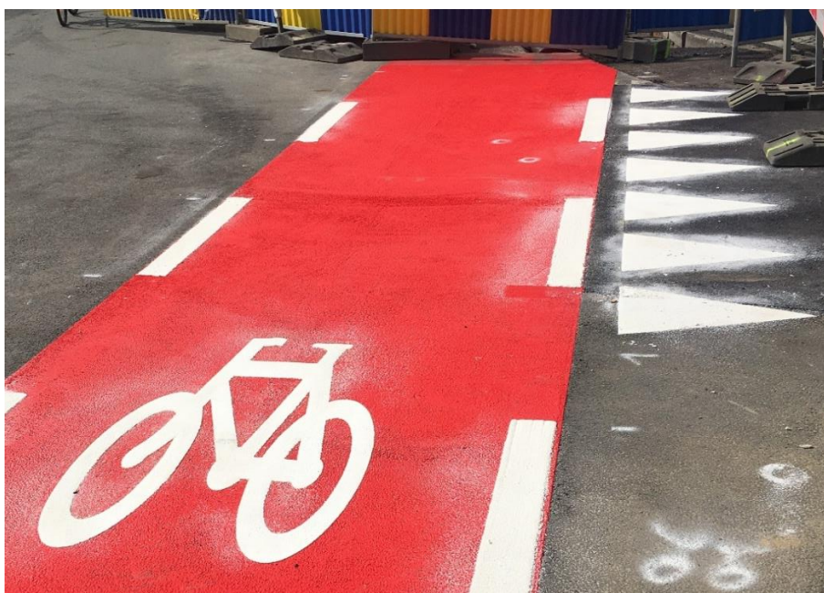
Figure 1.9 : réfection d’une piste cyclable suite à la pose d’un câble
