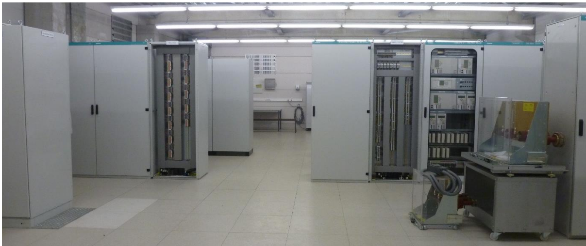
Figure 1.6 : équipements secondaires d'une sous-station
