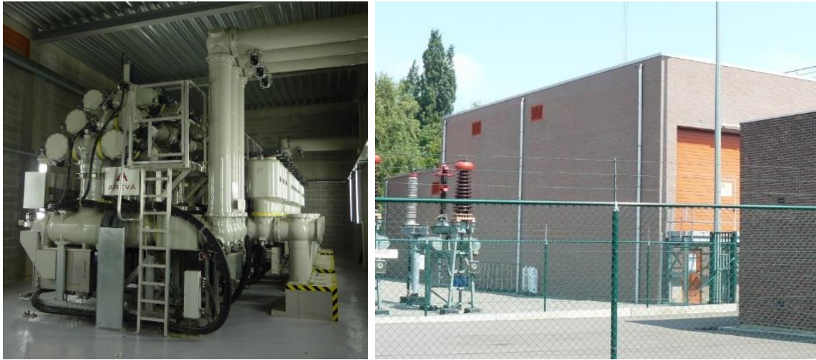
Figure 1.5 : sous-station 150 kV de type GIS
