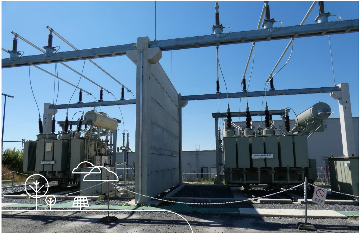
Transformateurs à Neufchâteau
